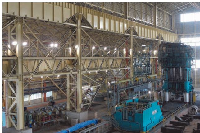
図12 工場照明の例 Fig. 12 Example of a factory lighting
